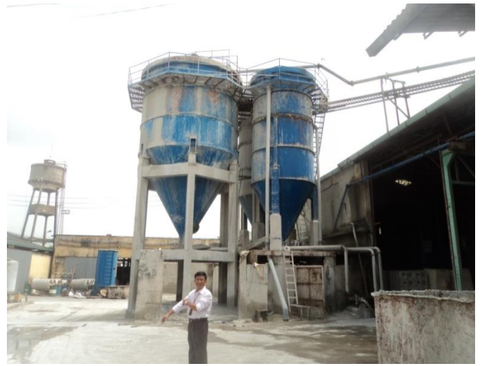
Hình 24. Tháp xử lý nước của Công ty Navifico-Thủ Đức, TP. HCM
