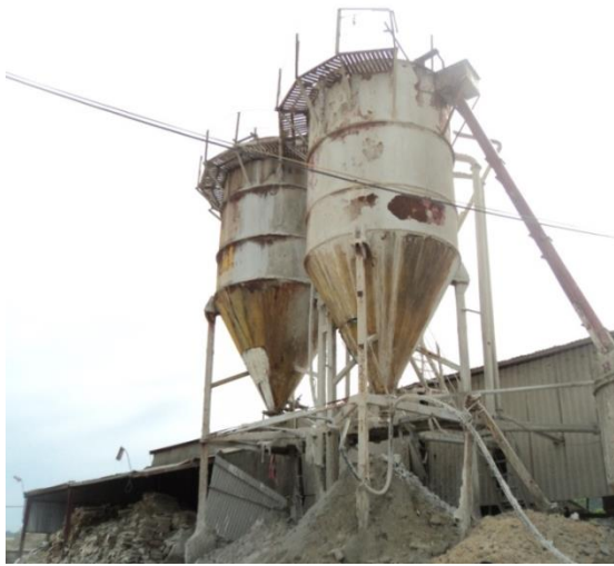
Hình 23. Tháp xử lý nước của Công ty Trung Nam-Hà Tĩnh
